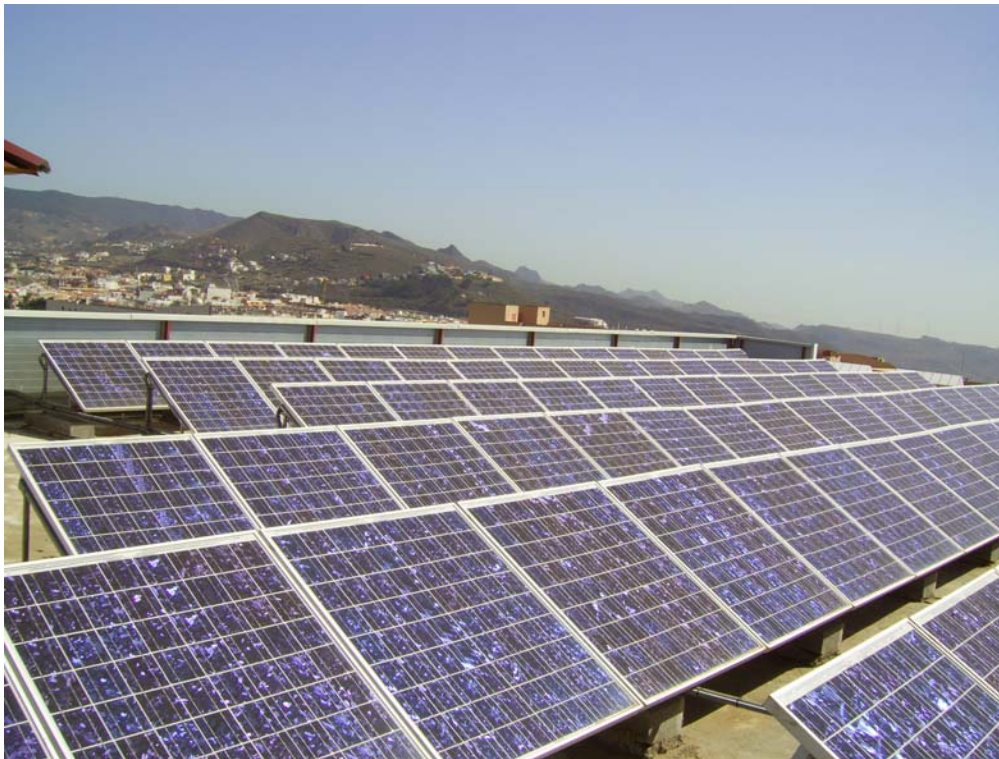
Imagen 1.- Vista del tejado del Nuryana con los paneles de células solares fotovoltaicas
