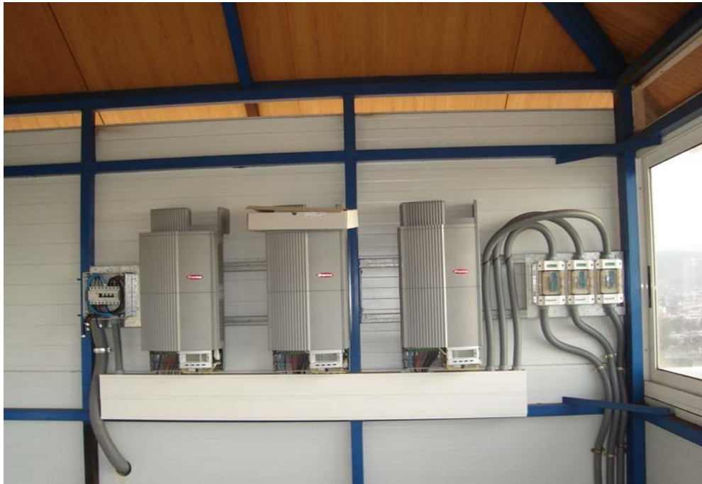
Imagen 3.- Vista de los inversores conectados a la salida de los paneles, que convierten la corriente continua en alterna
