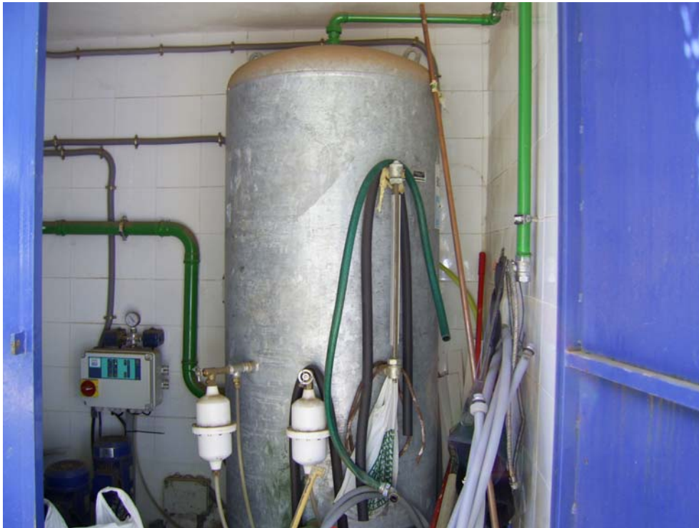
Imagen 9.- Vista del cuarto de bombas y depósito acumulador del sistema de distribución del agua del aljibe
